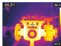
Hőszigetelő burkolat nélkül
