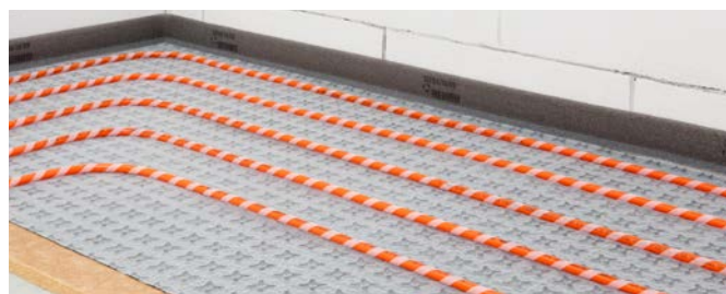
4-42. ábra: RAUTHERM SPEED plus tépőzárás rendszer alacsony beépítési magassághoz Knauf farost hőszigetelő lemezen WF
